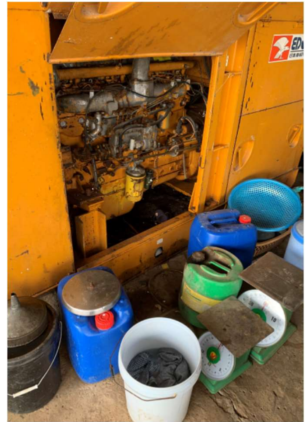
停電時に稼働する発電機
